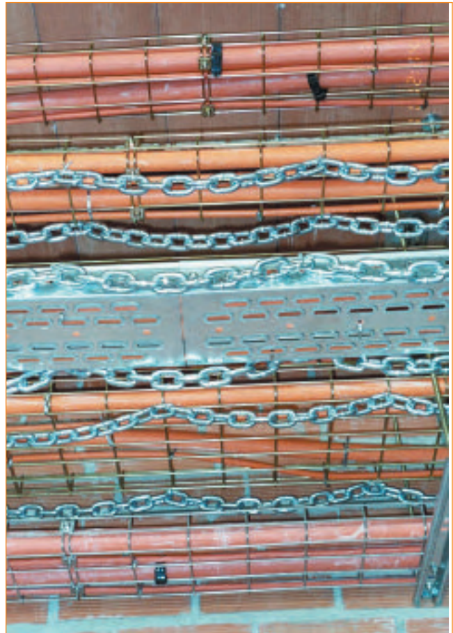
En la figura de la página anterior (1): Instalación con Rejiband a la vista. Arriba (figura 2), instalación para el ensayo según DIN-4102-12 con cables libres de halógenos y resistentes al fuego.
