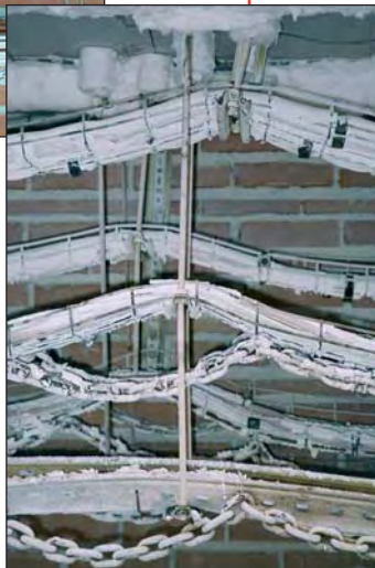
Figura 3. Estado final tras el ensayo
