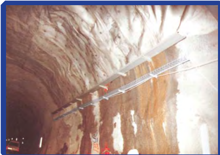
Zona del ensayo de incendio, con la lámina de impermeabilización y dos modelos de bandejas porta-cables instalados.
