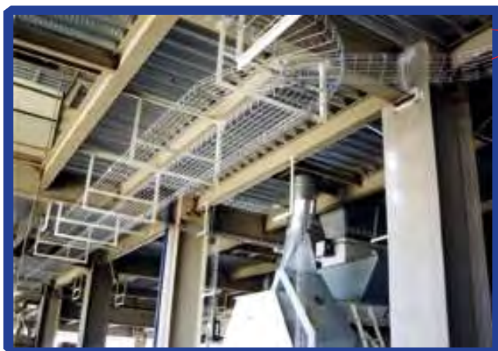
Rejiband en instalación industrial.
