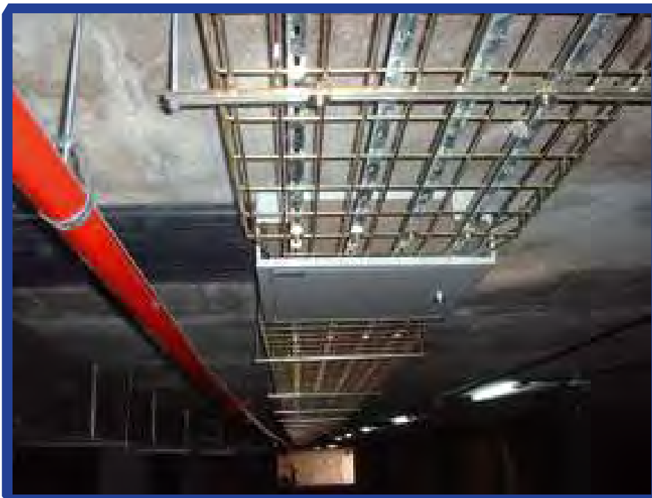
Rejiband instalada con tabique separador.
