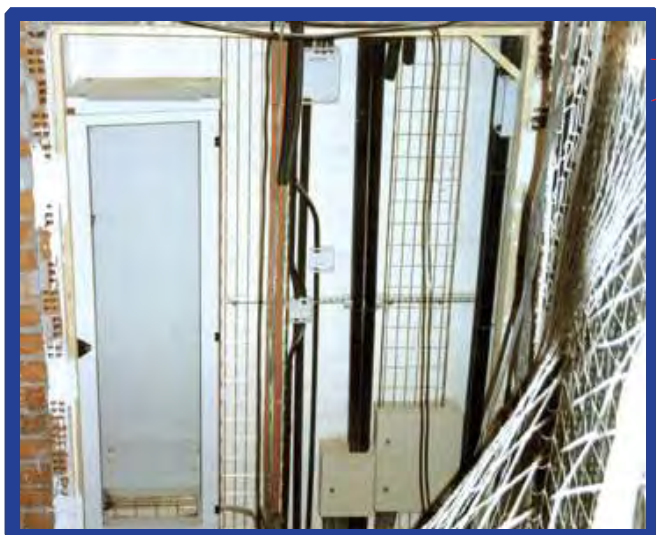
Rejiband en conducto cerrado de obra.
