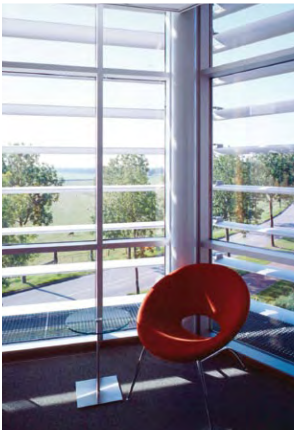
Detalle instalación Icarus fijo en edificio universitario vista desde el interior.
