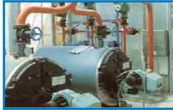
CENTRAL DE PRODUCCIÓN DE AGUA CALIENTE PRODUCTION D'EAU CHAUDE
