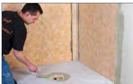
13 Aplicación del adhesivo en capa fina en la zona de apoyo del elemento de desagüe.
