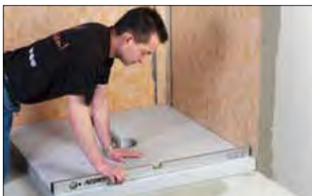
7 Nivelar el panel de compensación si éste se ha colocado mediante pegotes de mortero.
