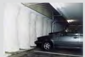
Defectos de diseño
