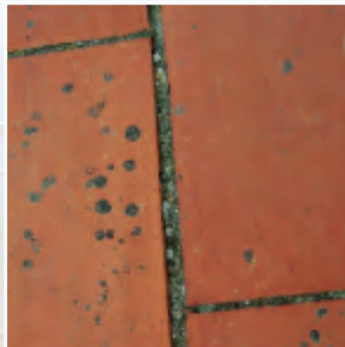
Pavimento antiguo en baldosín catalán con juntas que requieren un tratamiento antes de la aplicación de Aquaflex Roof
