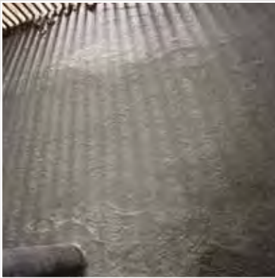
4. Después del mantenimiento de Mapelastic Foundation se vuelve perfectamente impermeable
