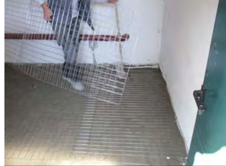
Poner sobre Polynum BLH, capa de compresión de entre 3 y 4 cms de hormigón
