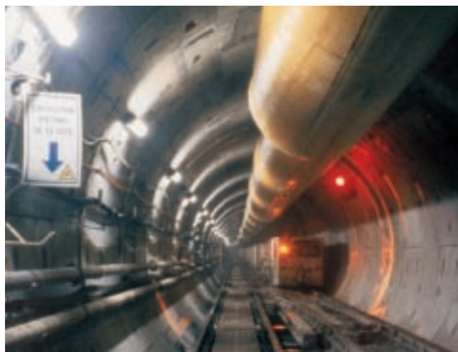
Las luminarias MY 1 han servido para la iluminación de la obra del túnel del canal de la Mancha.
