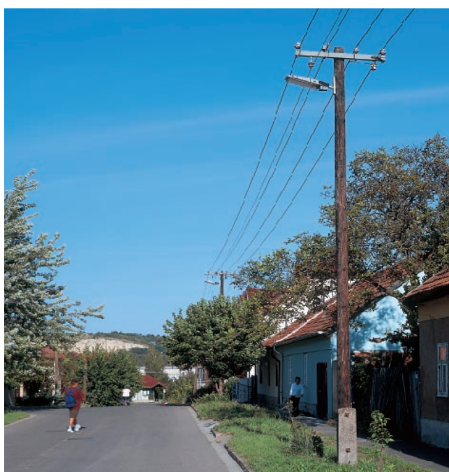
Altra es una luminaria que resulta muy económico tanto en gastos de instalación como en consumo energético.
