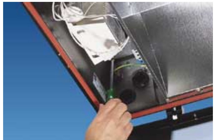
Los auxiliares eléctricos están fijados a una placa desmontable.
