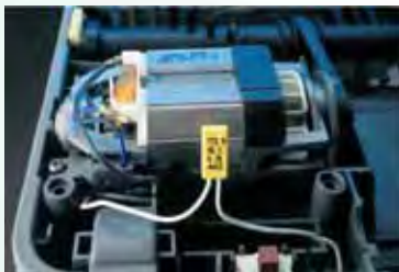
Protección de trafos, balastos, motores, circuitos...
