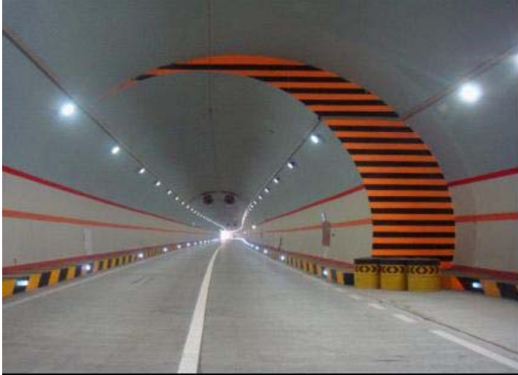
Iluminación de túnel de 1.290 metros, dos sentidos de circulación.
