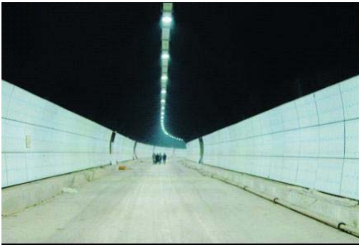
Iluminación de túnel urbano de 780 metros, dos sentidos de circulación.
