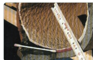
Estado no satisfactorio de una tubería rehabilitada después de tres años: Corrosión del mortero de cemento a razón de 1mm / año. Causa: agua de embalse excesivamente blanda.
