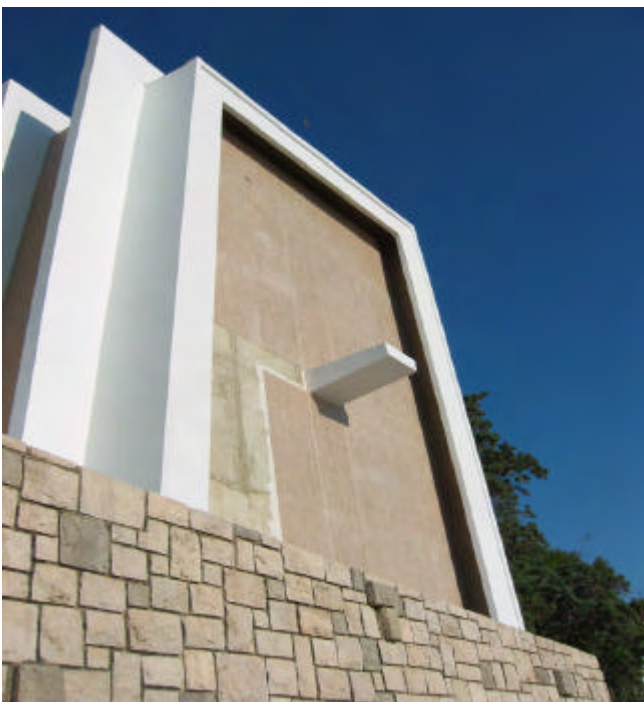
Foto 2: Un momento durante la aplicación del revestimiento cerámico con FLEXMORTEL. Puede verse también la parte de la estructura acabada con MASTERSEAL 325E.
