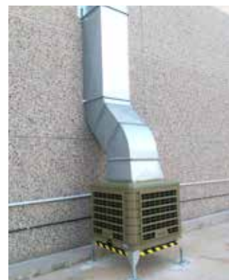
EC-18-VS instalado en pádel indoor
