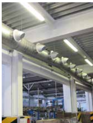
CI-300 Boca de impulsión
